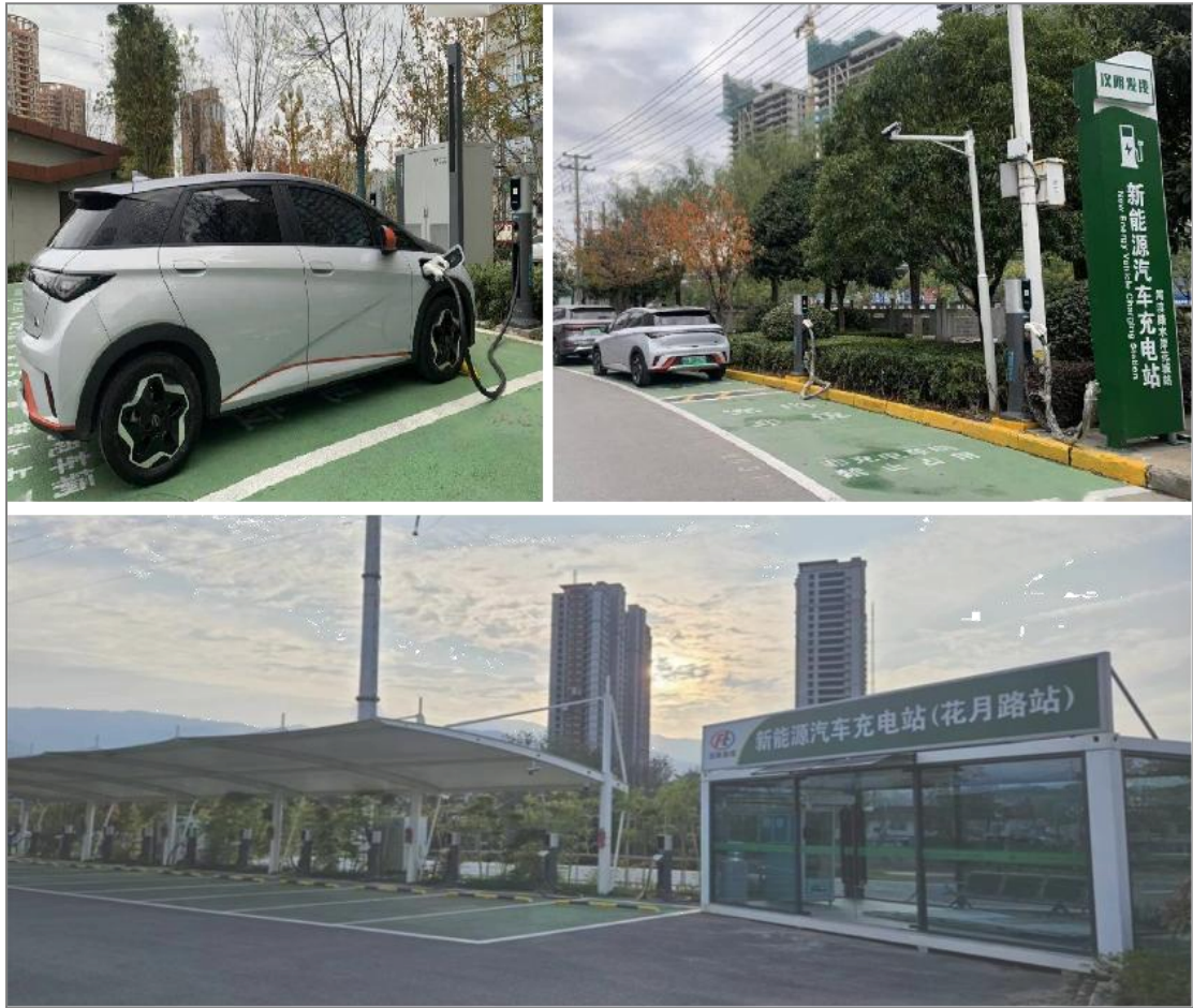
图 2.6 汉阴县充电桩设施建设概况实景图
